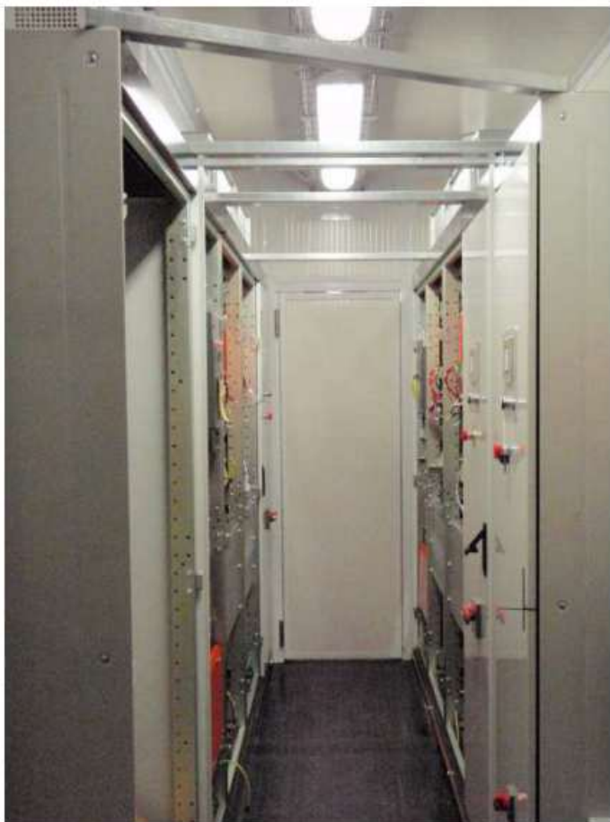
Locale servizi (Quadri ausiliari e inverter)
