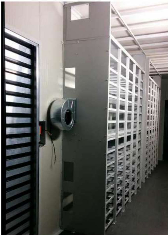
Armadio-rack per il contenimento delle batterie
