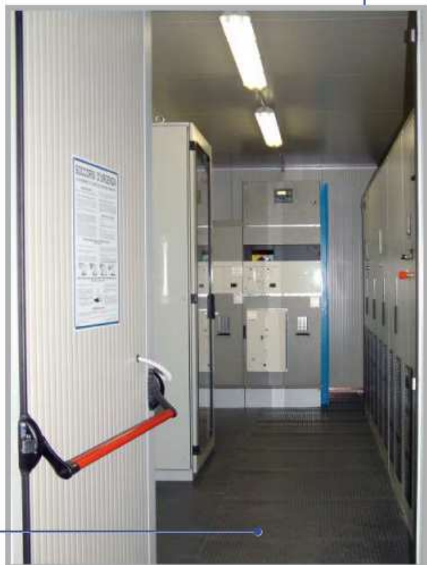
Vista interna del locale inverter climatizzato
