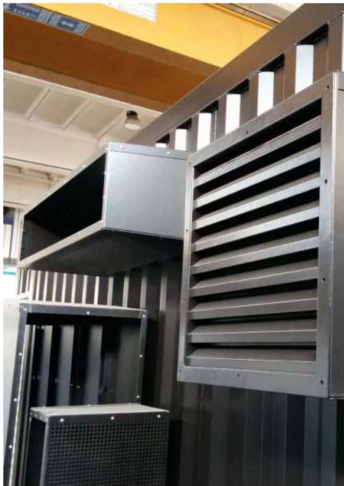
Condotti e griglie di ventilazione esterni
