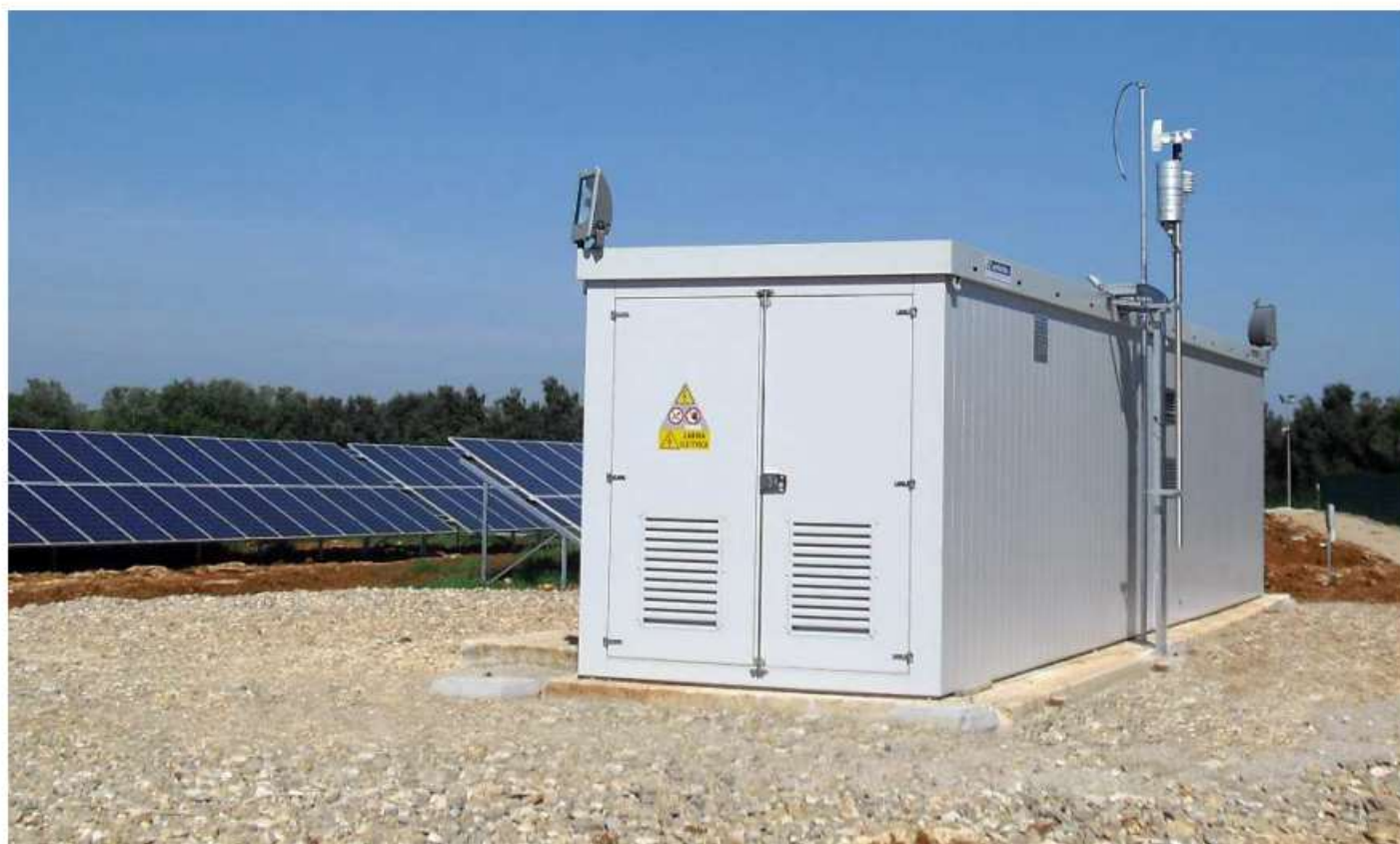
Shelter per campo fotovoltaico - Locale QBT / Trafo / Locale QMT - Dim. 9000x2400x h2700 mm
