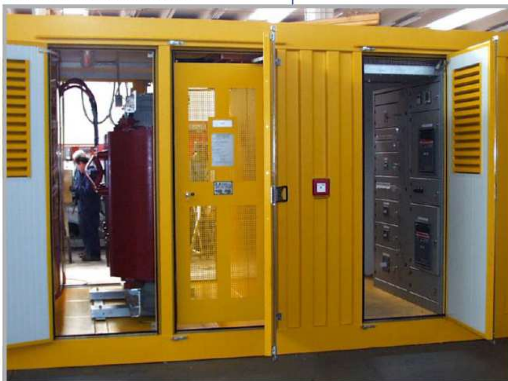
Vista interna del locale trasformatore e quadro BT
